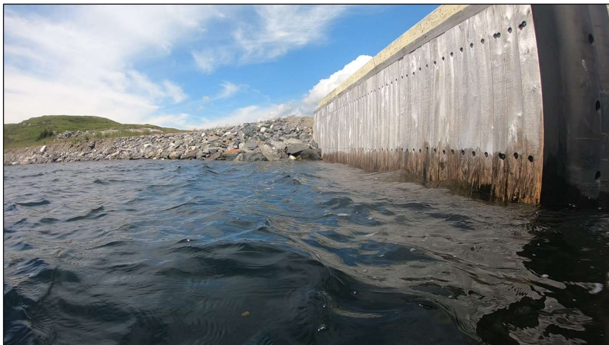
Photo 52 : partie de quai et rivage en enrochement dans la section ST4.
